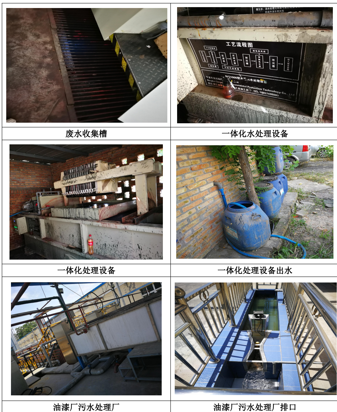
图 3-6 项目废水处理设施图
